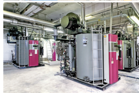
▲ 廠房的新煤氣鍋爐和供氣設備已全面投入運作，有助達致營運與環保雙贏。
