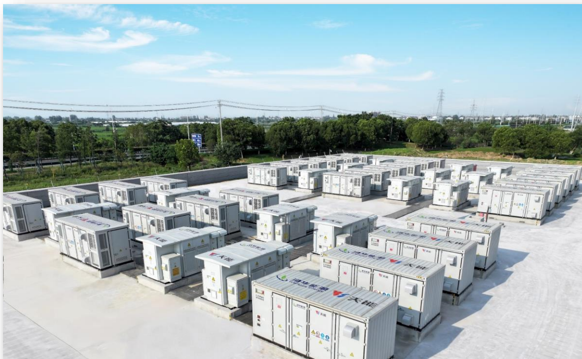
案例：马鞍山天能100MWh储能电站 (总投资1.3亿元，港华股比25%，IRR超15%)
