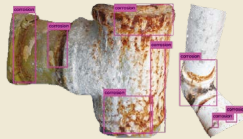
▲ 技術員將立管錄影視頻上傳至煤氣立管智能分析系統，系統運用AI技術自行識別立管的鏽蝕位置。
