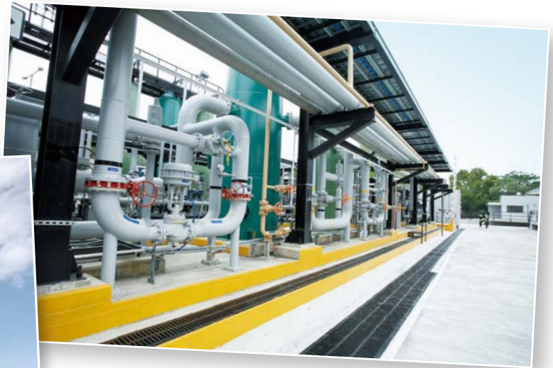
▲ 位於將軍澳新界東南堆填區沼氣應用項目，是煤氣公司其中一項『轉廢為寶』概念項目。 The landfill gas utilisation project at South East New Territories Landfill in Tseung Kwan O, Hong Kong, is an example of Towngas' waste-to-treasure initiatives.
