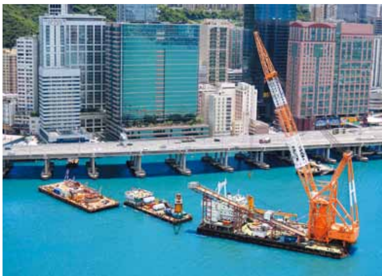
為配合政府之東南九龍發展計劃，我們為連接土瓜灣與北角之雙海底管道進行改道工程。
