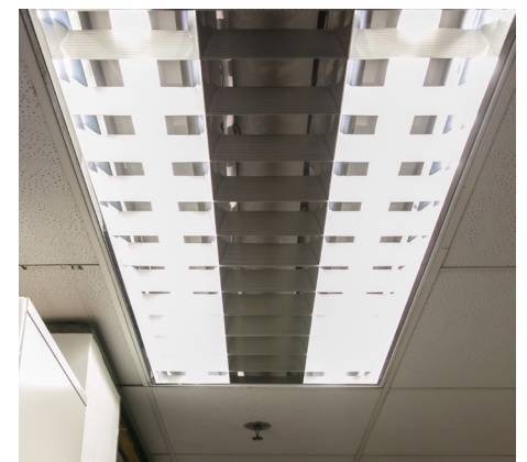
辦公室內設置三大高效能照明設備，有效節能。
