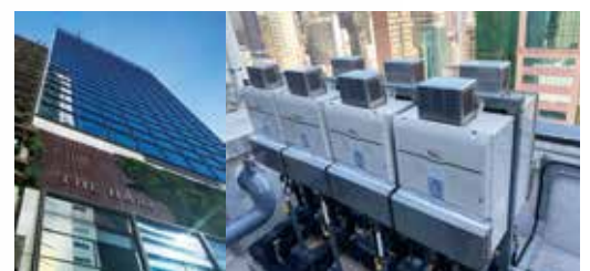
▲ 煤氣公司於The Hari酒店的天台位置安裝商用熱水系統，為酒店供應源源不絕的熱水。
