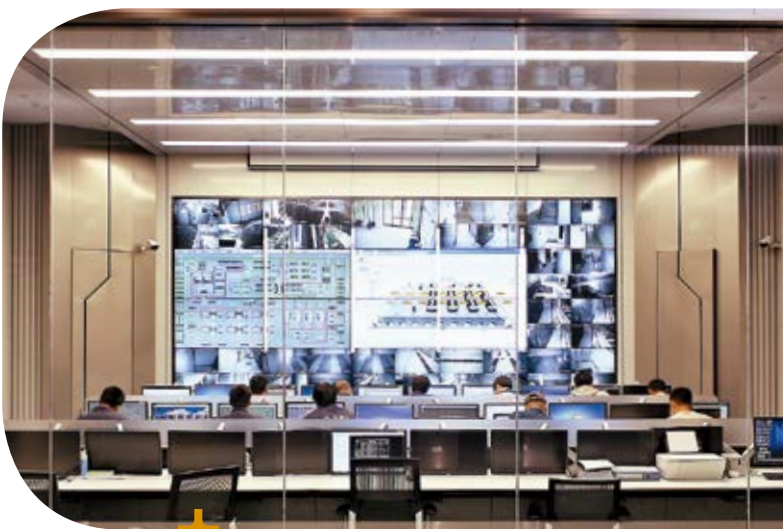
名氣通北京1號數據中心於2017年已開始投入運作。
